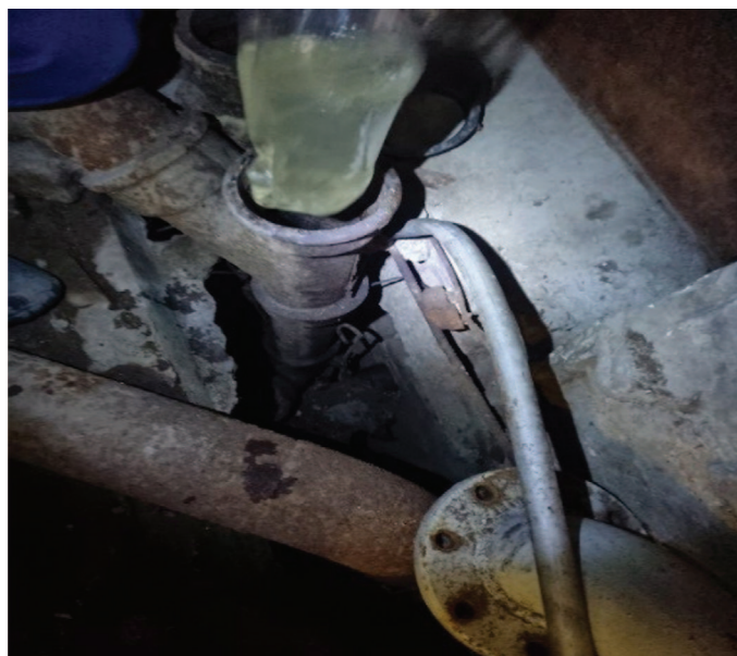
Рис. 1. Забор сточных вод из клинического корпуса НИИ урологии. Fig. 1. Wastewater intake from the clinical building of the Research Institute of Urology
